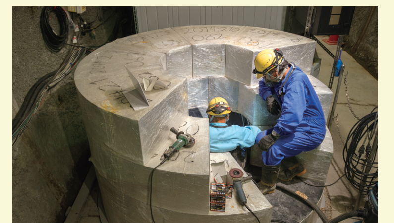
深度350m調査坑道内に設置されている人工バリアの緩衝材の展示物
